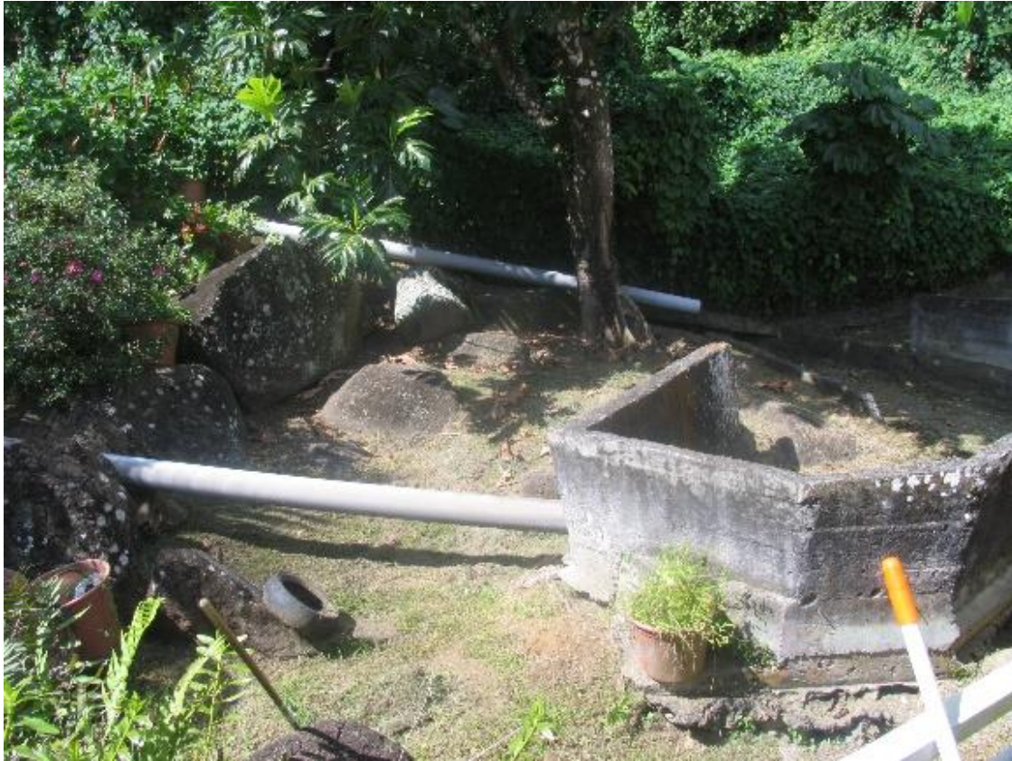
Vue du bassin collecteur des eaux de ruissellement
